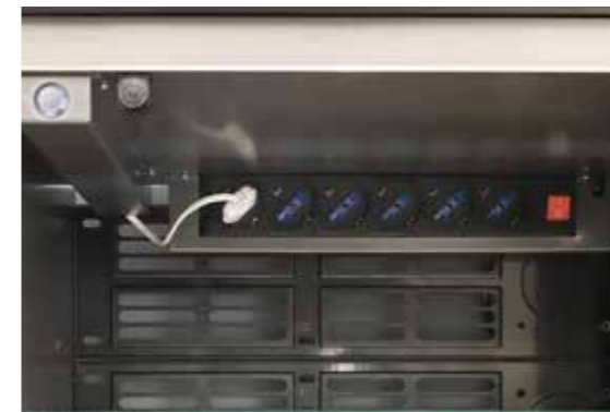
Mehrfachsteckdose bei allen TV-Elementen
